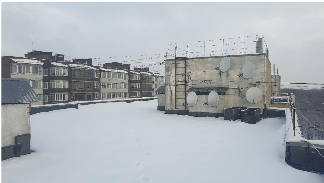
Рисунок 3.1 – Вигляд даху 1-го під'їзду будинку на вулиці Лісогринівецькій, 18
