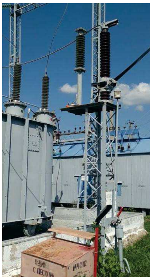
Рисунок 1.7 - Заземлювач трансформатора ЗОН-110
