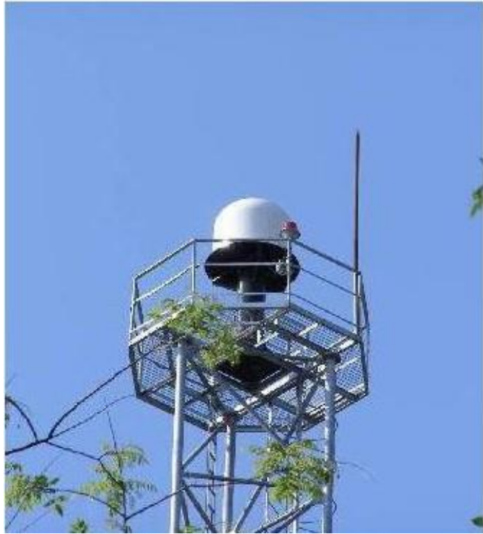
Рисунок 1.1 – Вежа, обладнана радіолокаційною системою
