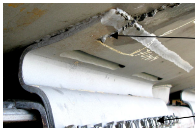
Рис.2. Трещины фасонной лапы
