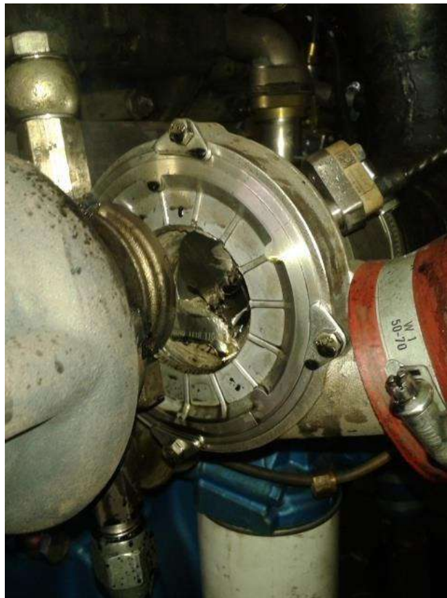
Рис.4.2 – Загальний вид місця руйнування ТКР-50.
