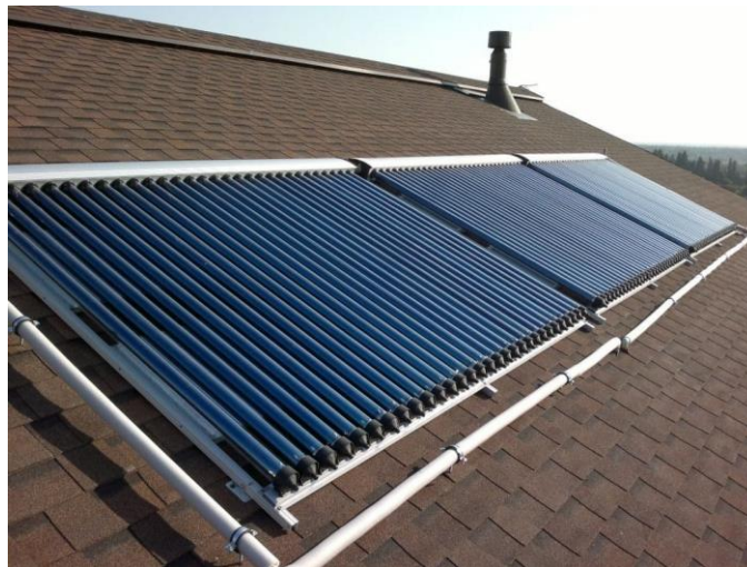
Рисунок 1.18 – Вакуумний колектор на даху будинку
