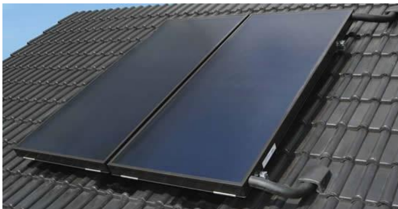
Рисунок 1.15 – Плоский сонячний колектор на даху будинку
