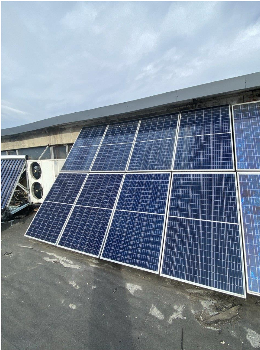
Рисунок 2.7 – Сонячні панелі встановлені на даху кафедри
