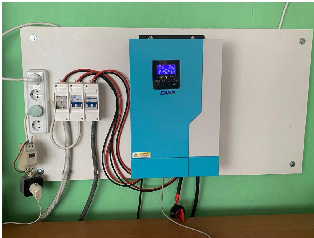
Рисунок 2.10 – Загальний вигляд побутової гібридної сонячної електростанції
