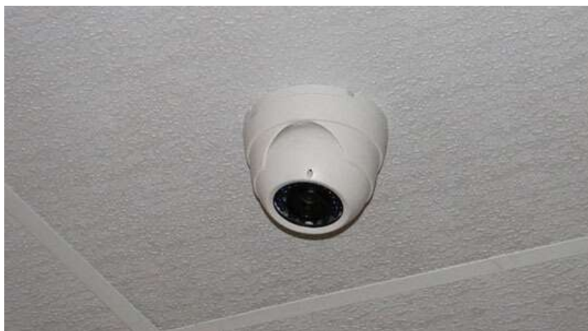
Рисунок 1.4 – Приклад розміщення відеокамери [15]
