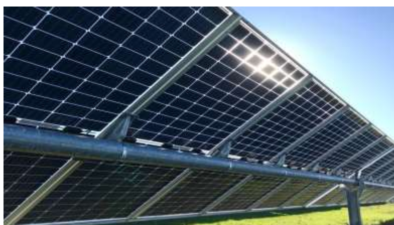
Рисунок 1.18 - Загальний вигляд двосторонніх сонячних панелей
