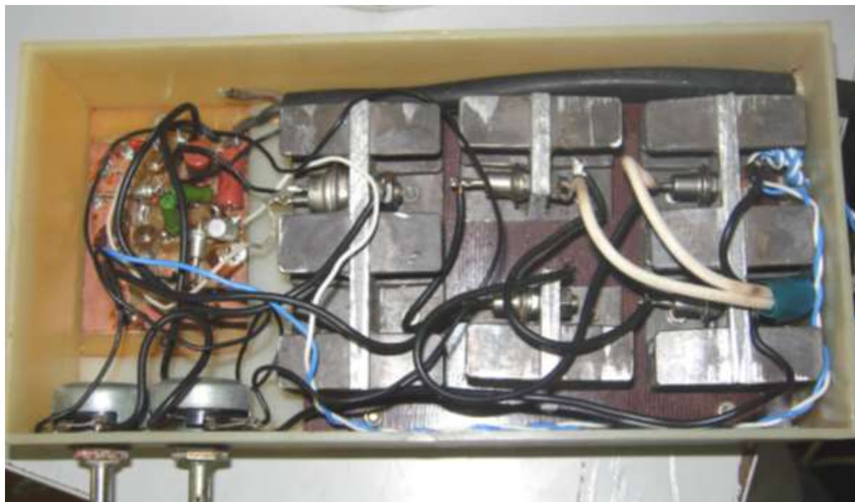
Рисунок 3.12 – Внутрішній вигляд регулятора температур
