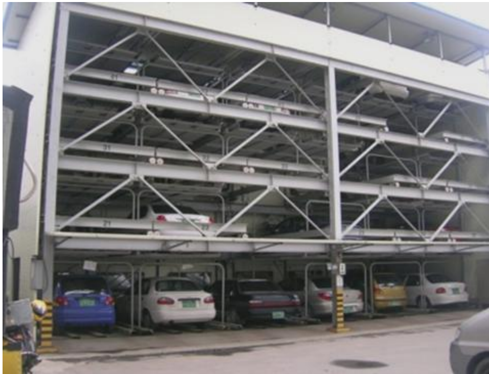
Рисунок 1.2 – Автостоянка із сталеву конструкцією
