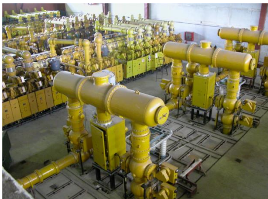
Рисунок 1.2 – Загальний вигляд залу КРПЕ [15]
