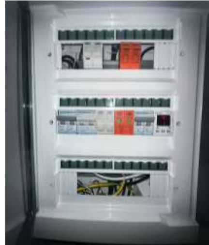
Рисунок 2.20 - Шафа керування та захисту побутової сонячної електро-станції
