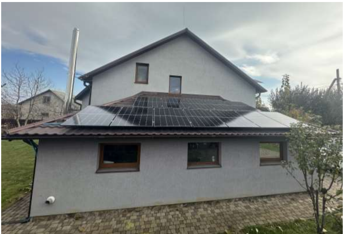
Рисунок 2.18 - Розміщення сонячних панелей стрінга 2 на гаражі
