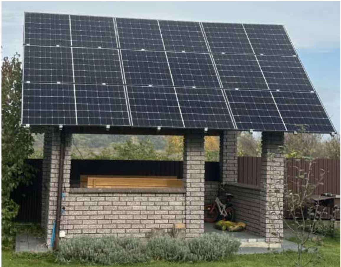
Рисунок 2.17 - Розміщення сонячних панелей стрінга 1 на альтанці
