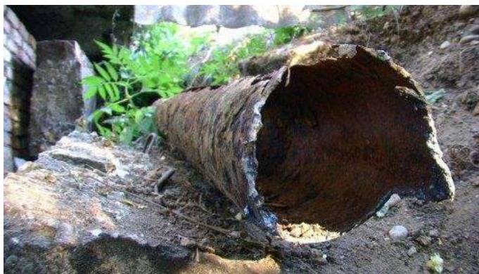
Рисунок 1.8 – Корозійне руйнування трубопроводу у ґрунті
