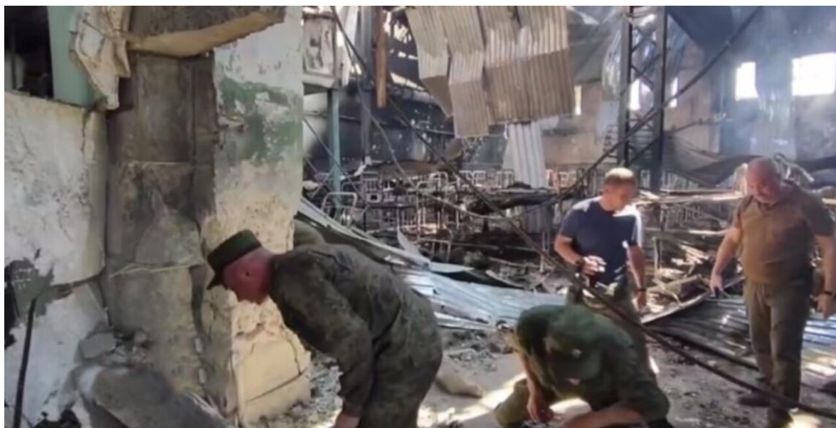
Рисунок 3.3 – Огляд зруйнованого приміщення військовими фахівцями
