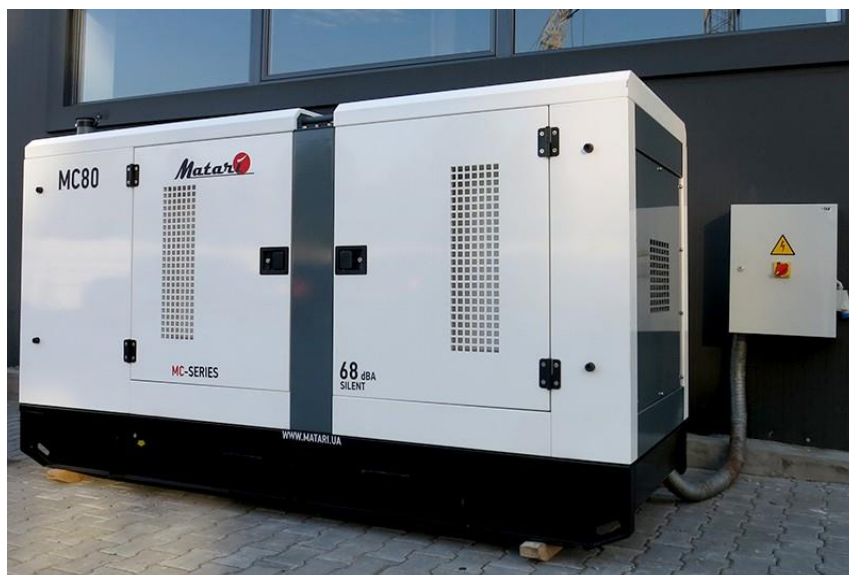
Рисунок 1.2 – Генератор потужністю 88кВт, встановлений біля магазину
