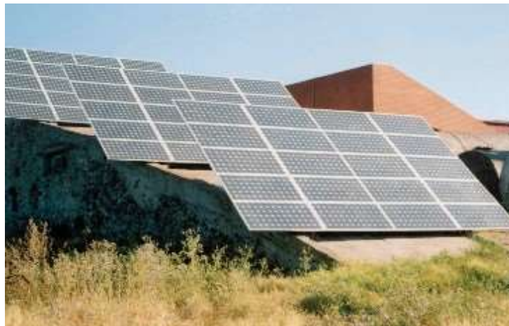
Рисунок 1.12 – Фотоелектрична система енергопостачання комплексу на о.Зміїний потужністю 10 кВт
