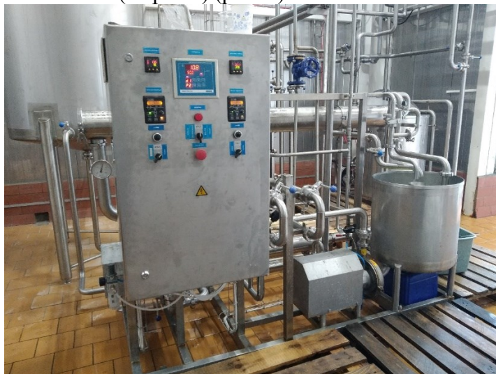
Рис. 2. Автоматизована установка мікрофільтрації розсолу типу АУМФ–1
