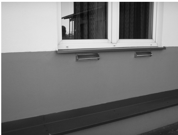
Рис. 2 . Загальний вигляд місцевих систем припливної вентиляції
