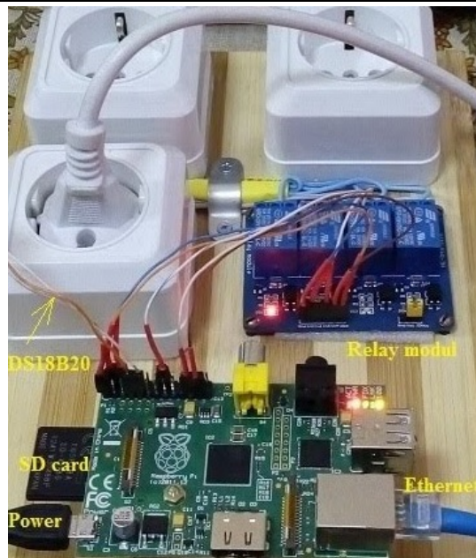
Рис. 2. Фото системы управления электропитанием
