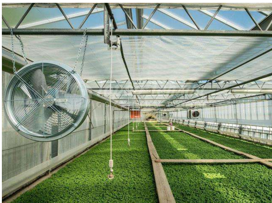
Рисунок 1.19 – Вентилятори для циркуляції повітря в теплиці [34]
