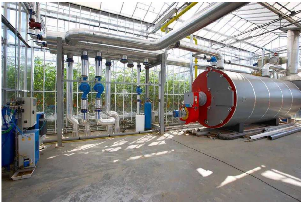
Рисунок 1.7 – Газові котли в теплиці [12]
