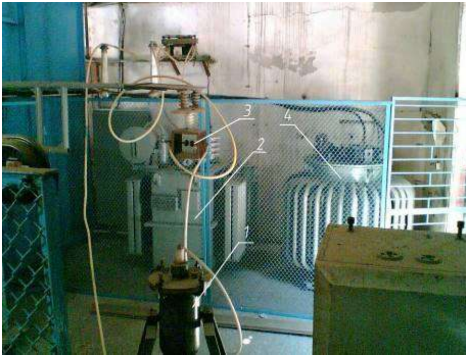
Рис. 4.2. Зовнішній вигляд високовольтної установки з енергією розряду 5 кДж:
