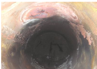
Рис. 2. Наслідок дії лужної корозії теплообмінника
