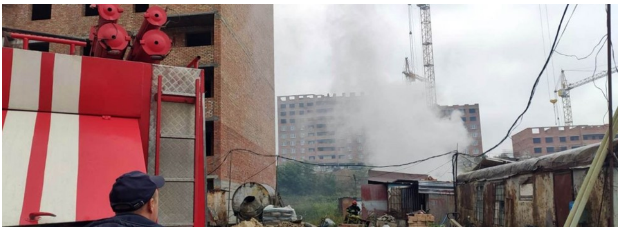
Рисунок 2.10 – Гасіння пожежі на будівництві у Хмельницькому
