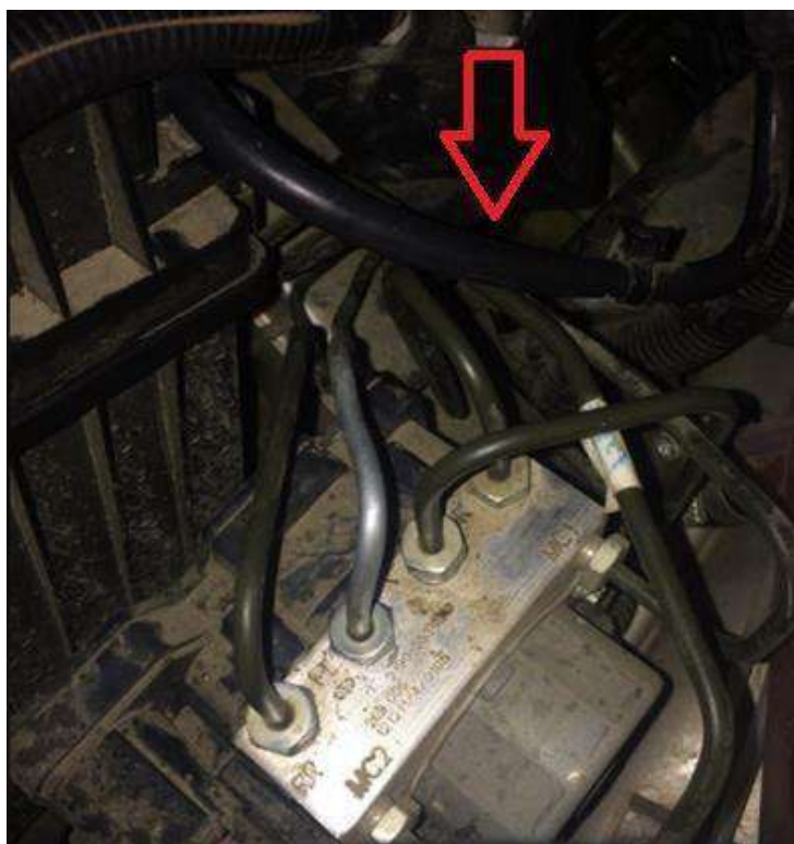
Рисунок 26 – Торкання гальмівних трубок із шлангом розширювального бачка
