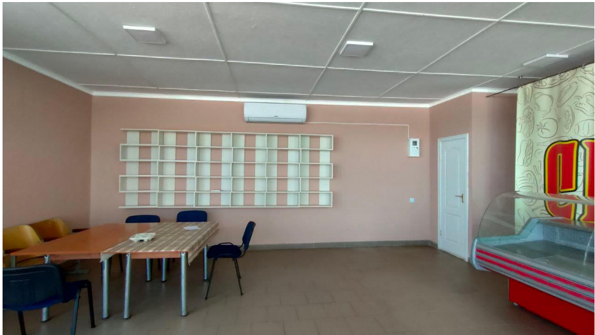
Рисунок 1.3 – Кондиціонер, полиці, електрощитова
