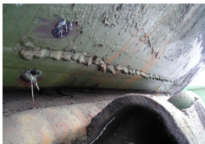
Рис.2. Зона сварного шва бокового и нижнего листа котла над лежневыми опорами
