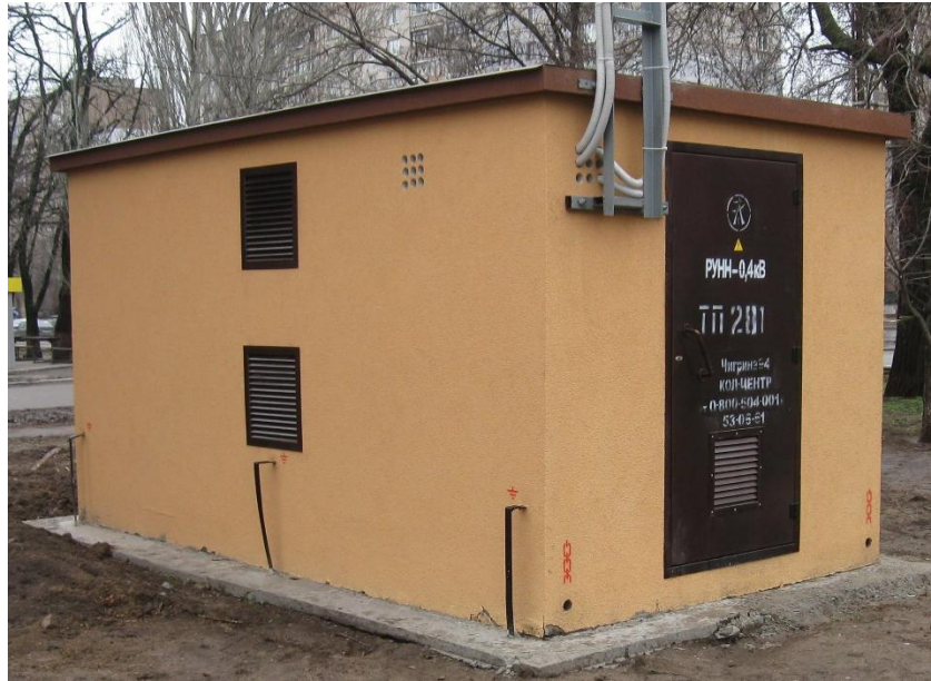
Рисунок 1.8 – Вбудована в будівлю трансформаторна підстанція [23]
