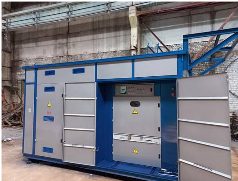
Рисунок 1.9 – Внутрішньо-цехова трансформаторна підстанція [24]
