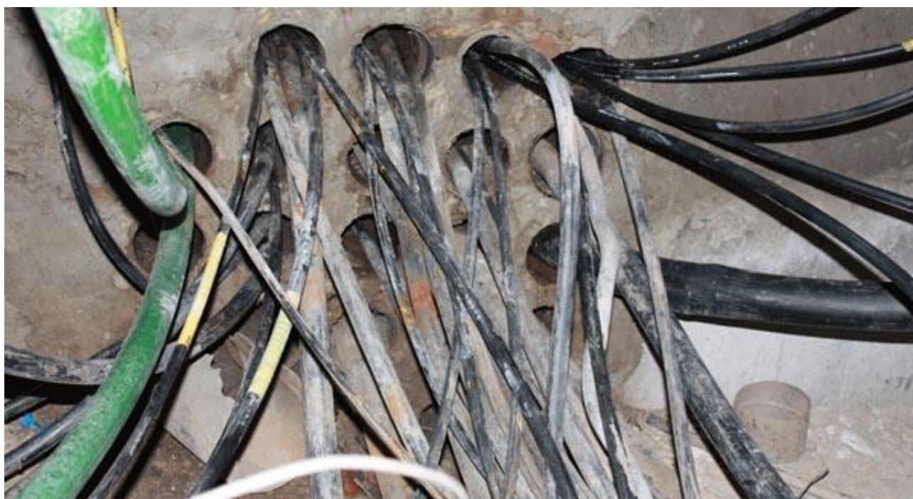
Рисунок 1.1 – Приклад пошкодження волоконно-оптичної лінії під час проведення земляних робіт
