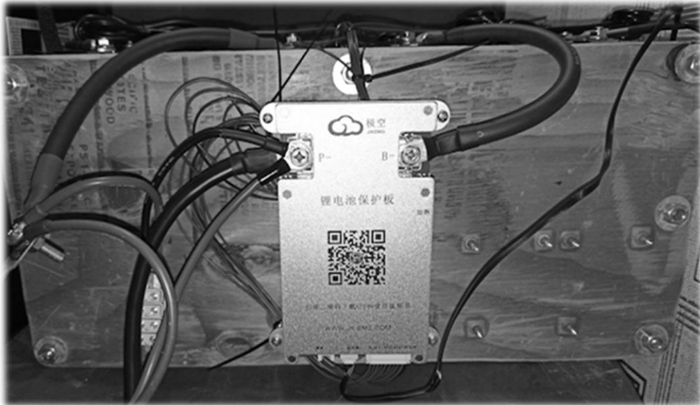
Рисунок 3.13 – Зовнішній вигляд кінцевого з’єднання акумуляторних комірок та периферійних кабелів (вид по центру)
