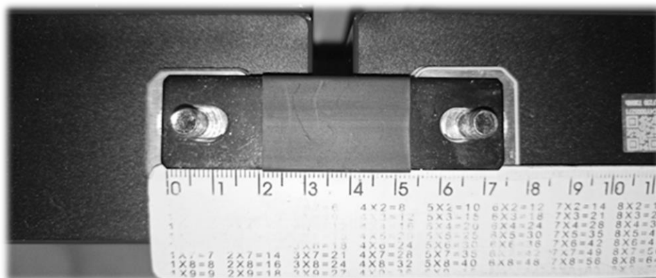
Рисунок 3.9 – Вигляд з'єднання двох акумуляторних комірок з використанням металевої струмопровідної шини
