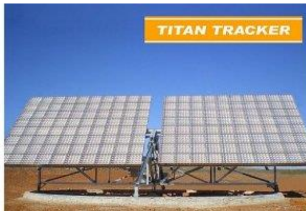
Рисунок 1.10 – Енергетична установка фірми Titan Tracker
