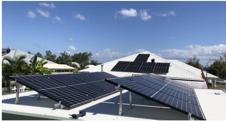
Рисунок 1.9 – Енергетична установка фірми Eco-$mart
