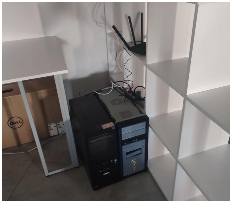
Рисунок-2.2 – Небезпечне розташування мережевого обладнання
