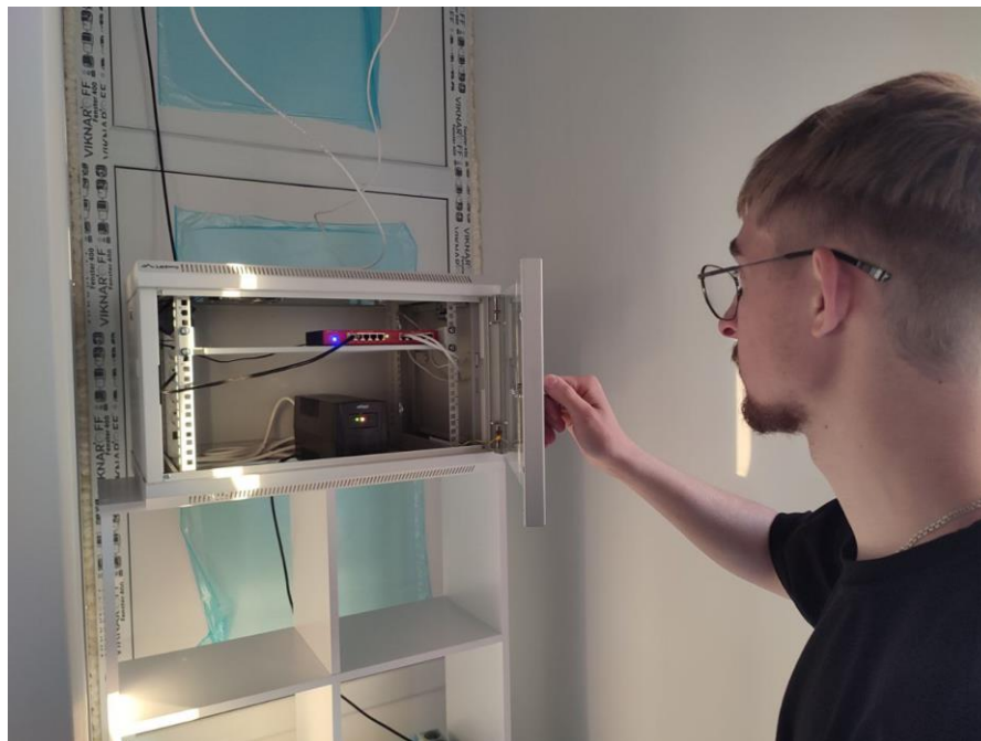
Рисунок 3.6 – Обладнана серверна шафа.
